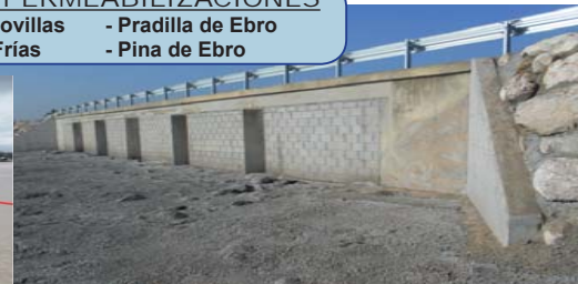
Marcos fusibles en la carretera A-1107. Pina de Ebro (Zaragoza)
